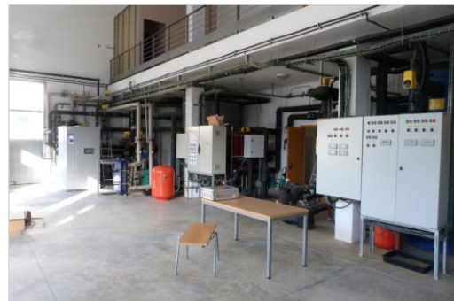
NAVE CIESOL – Instalación de frío solar
