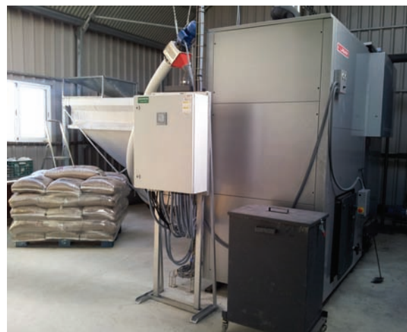
Figura. Caldera del sistema de calefacción.
