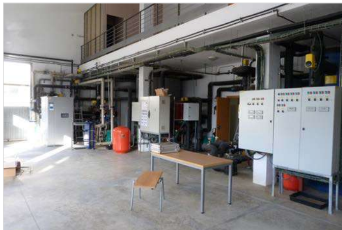
NAVE DE ENSAYOS DEL CIESOL – Instalación de frío solar
