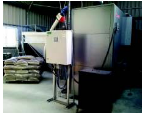
Figura. Caldera del sistema de calefacción.
