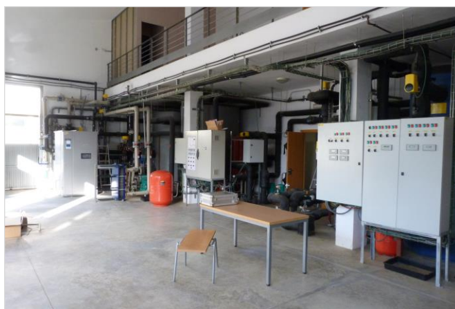
NAVE CIESOL - Instalación de frío solar
