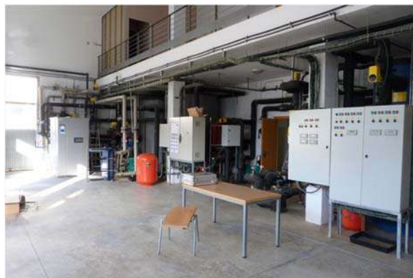
Nave CIESOL – Instalación de frío solar
